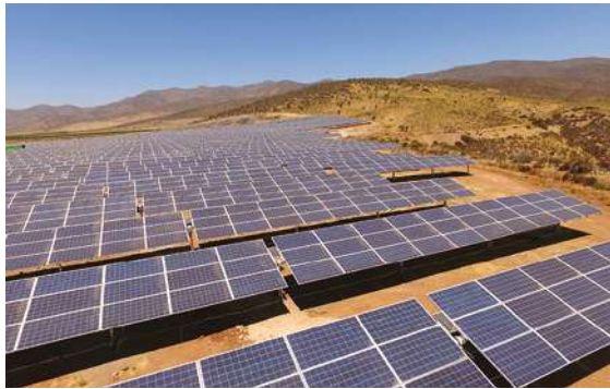
Instalación solar fotovoltaica: seguidor solar, Chile.
